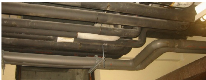
Rørisolasjon av cellegummi
